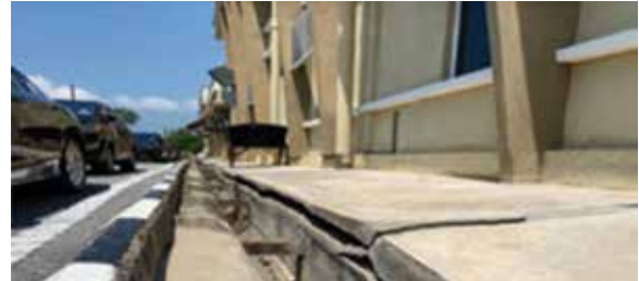
Kerosakan apron sekeliling bangunan sepanjang 370m
