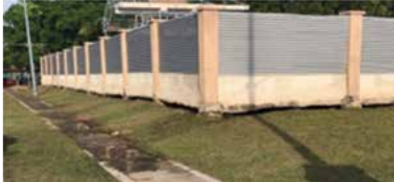
Kesan kebocoran paip akibat mendapan
